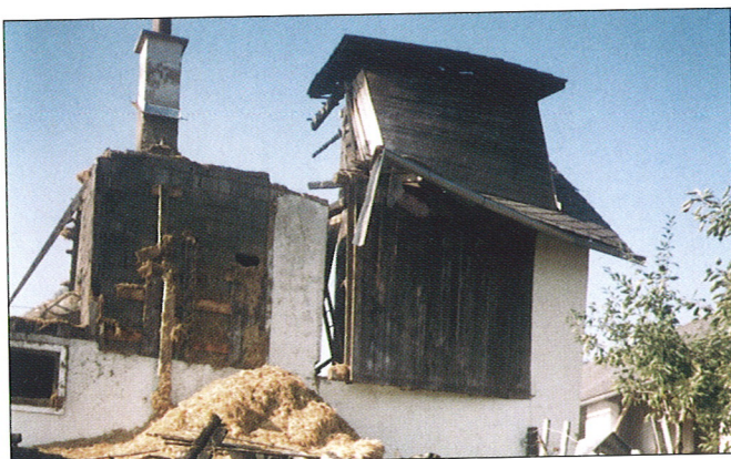
Wirtschaftsgebäudebrand bei Unterhuber
