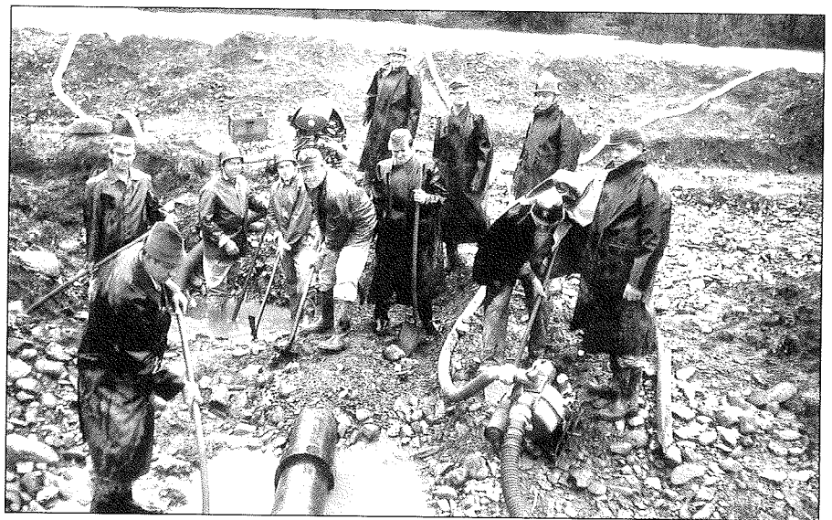
23. April 1972 - Rohrbruch der Ortswasserleitung, Nähe Schreinerhaus
